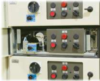
Vista del sistema de enclavamiento
