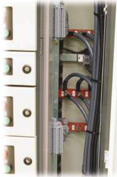
Conexiones de los cables de fuerza y de comando.
