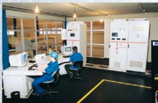
Sistemas de supervisión y control
