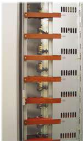
Vista posterior del CCM, barra vertical en el ducto metálico y garras de salida.
